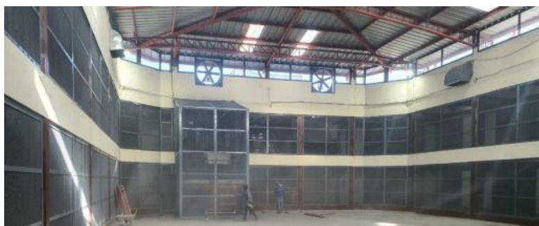
Vista panorámica de patio interior, al fondo se ve las gradas y pasillos recubiertos de malla acerada
