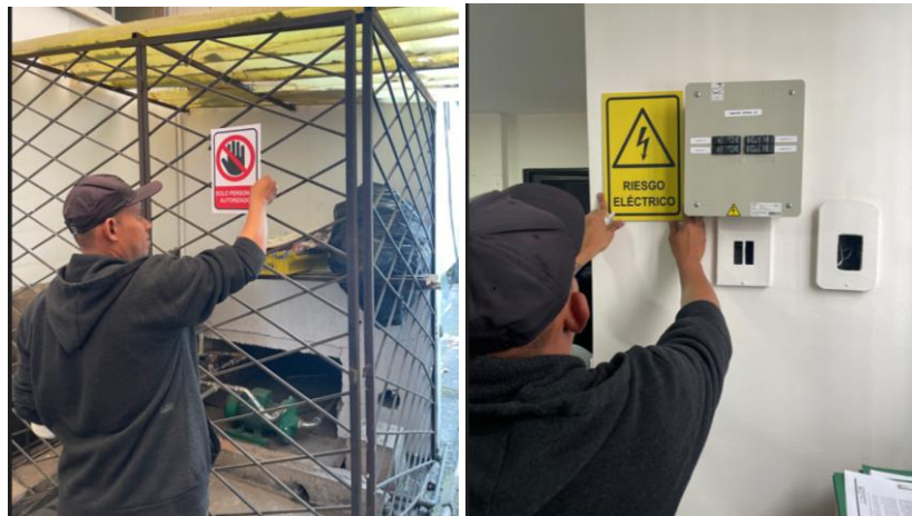
Imagen 1 : Instalación señalética edificio planta central.
