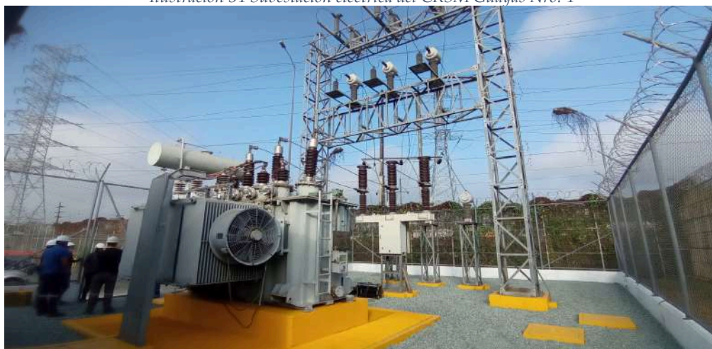
Ilustración 34 Subestación eléctrica del CRSM Guayas Nro. 4
