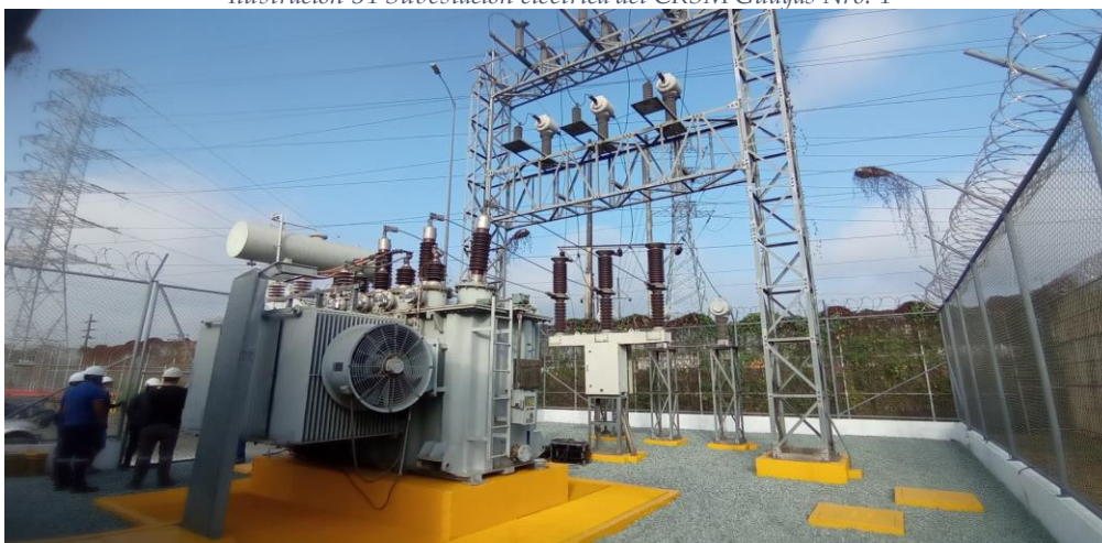
Ilustración 34 Subestación eléctrica del CRSM Guayas Nro. 4
